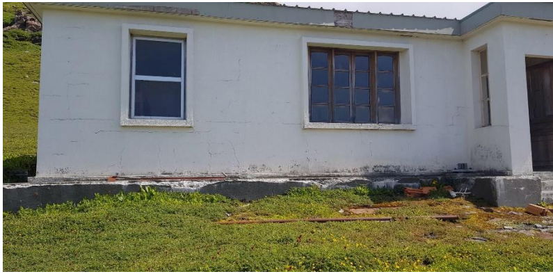
Façade fissurée et huisseries (©Kamel DOUFENE)
